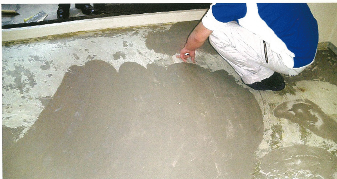
傷んでやせた下地に対して、補修作業を行わなければならない。
